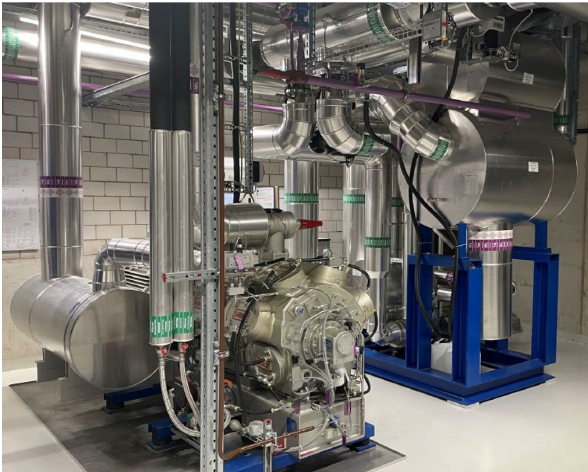
Abbildung 1: Beispiel einer industriellen Wärmepumpe in der Energiezentrale eines Schweizer Unternehmens (Foto: C. Arpagaus, OST IES, 4. Juni 2024).
